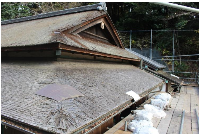
修理工事前の傷みの著しい屋根の様子
